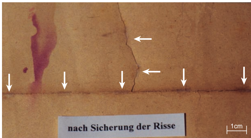
Abb. 13: Mit Sicherungsbrücken gesicherte Risse (Pfeile)
